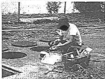
浄化槽保守点検
