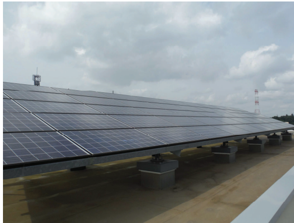
旭小学校の太陽光発電設備
