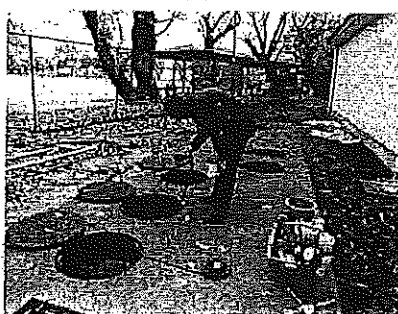
浄化槽保守点検
