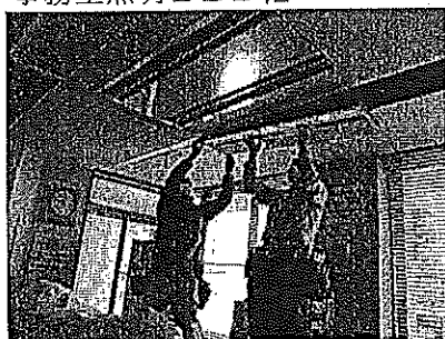
写真④ 事務室照明LED化
