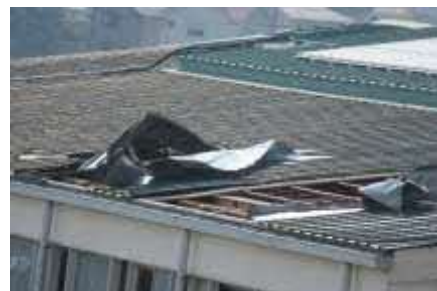
■ 令和元年台風15号による被害状況
